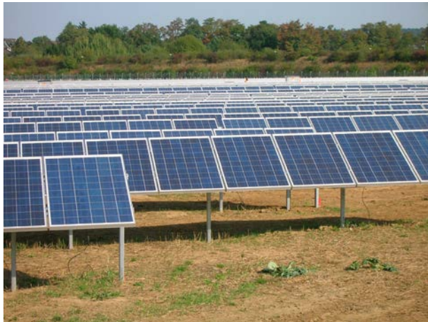
Solarpark Oberlar, 2009 das größte Solarkraftwerk in NRW
